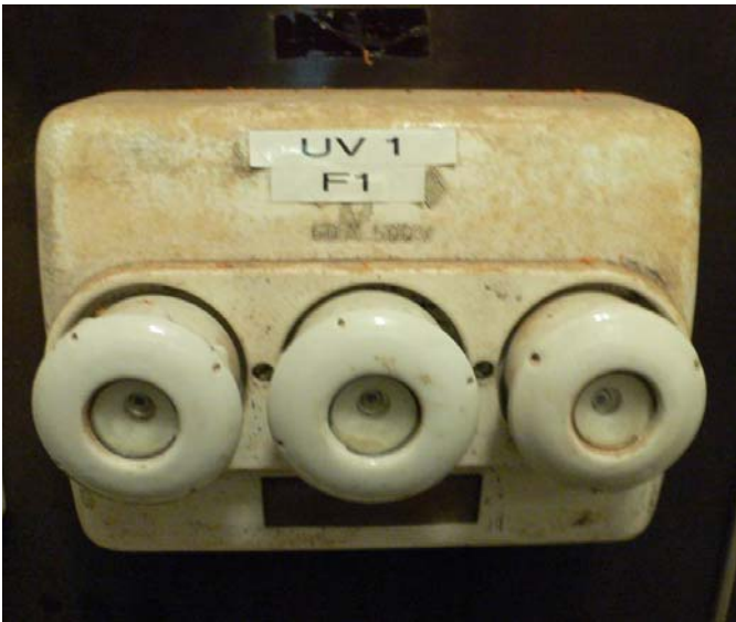
Hauptleitungssicherungen UV 1; Sicherungsknöpfe schwarz; Sicherungswert 40 A .
